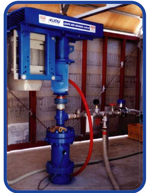
[PCポンプ地上部]
